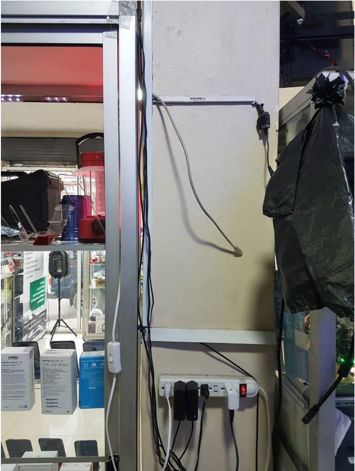
Figura 1.3 Estado cable de red de departamento técnico
