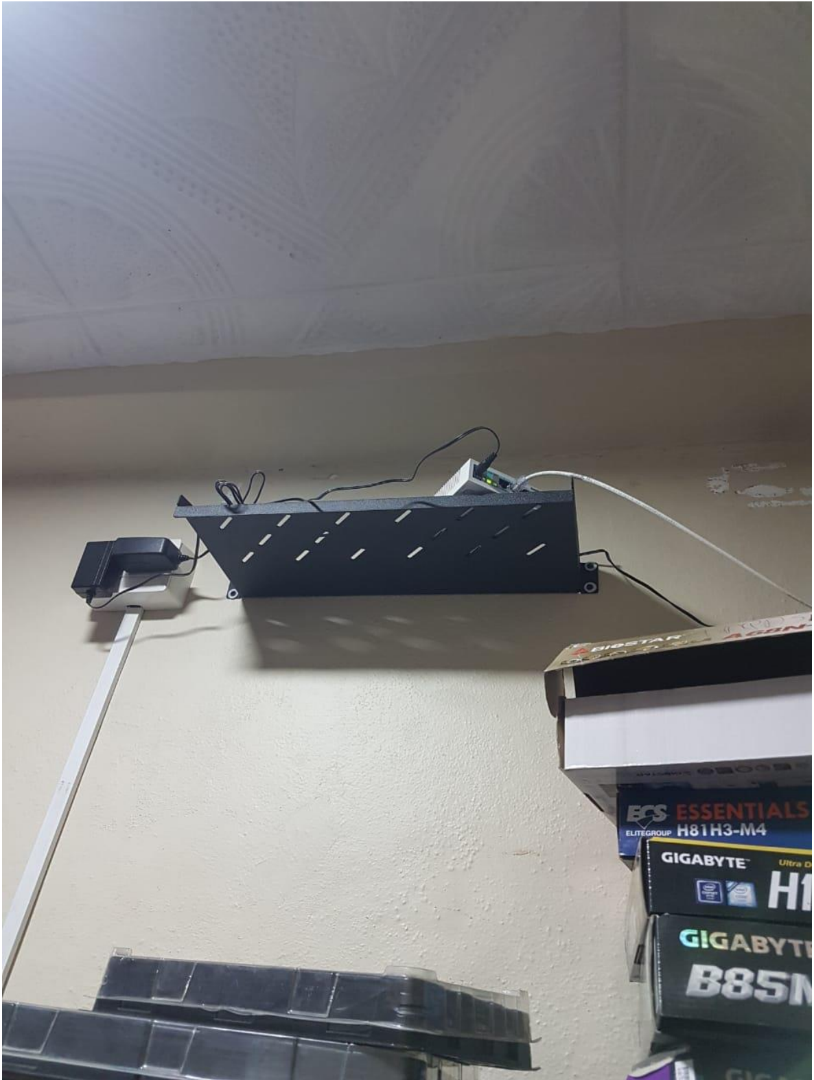
Figura 1.4 Estado Switch planta baja
