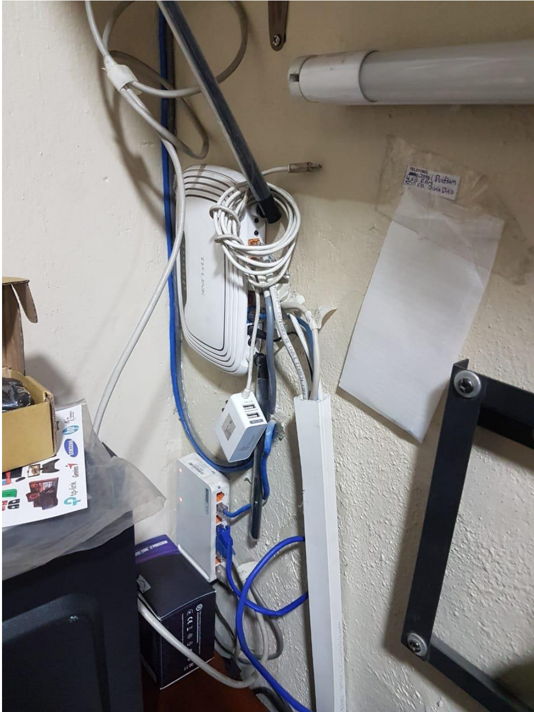
Figura 1.1 Estado router y switch planta baja
