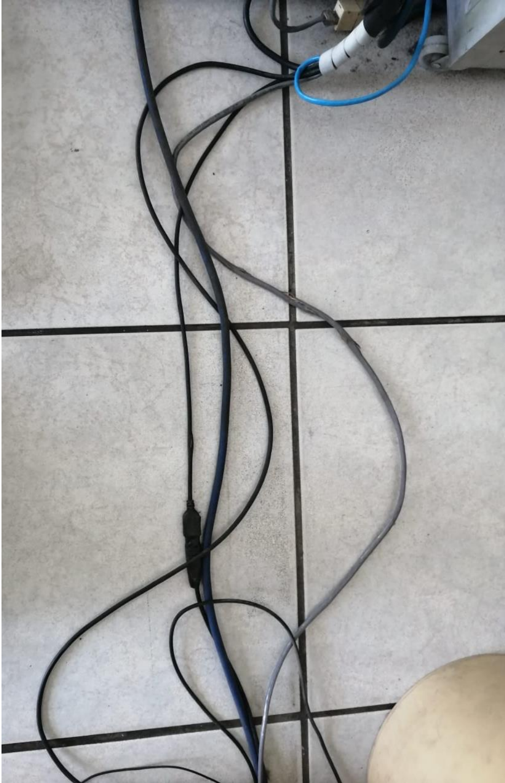
Figura 1.6 Estado cables Tejar
