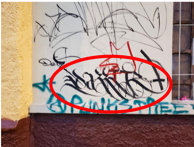
Figura 23. Tags reflejados en un muro parte de una vivienda. Fuente: Elaboración propia
